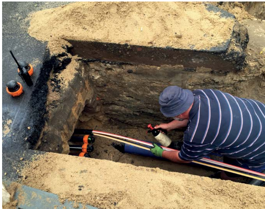
Bei der Verlegung von LWL-Leitungen werden vorhandene Leerrohre genutzt, hier: 50er PE-Rohre, die bei den Tiefbaumaßnahmen der letzten Jahre vorausschauend mitverlegt wurden.
