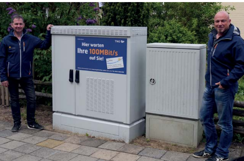
Im gesamten Stadtgebiet haben die Stadtwerke Soltau Multifunktionsgehäuse an das Glasfasernetz angeschlossen und versorgen damit die Haushalte mit schnellem Internet über die alten Kabelverteiler der Telekom.
