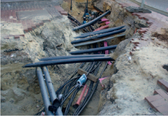
Komplexe Situation: Um die Infrastruktur im Innenstadtbereich effizient im GIS zu dokumentieren, müssen neue Wege beschritten werden.
